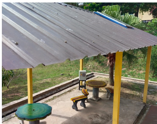
Rajah 4: Stesen Pengecas Solar sedia untuk digunakan
